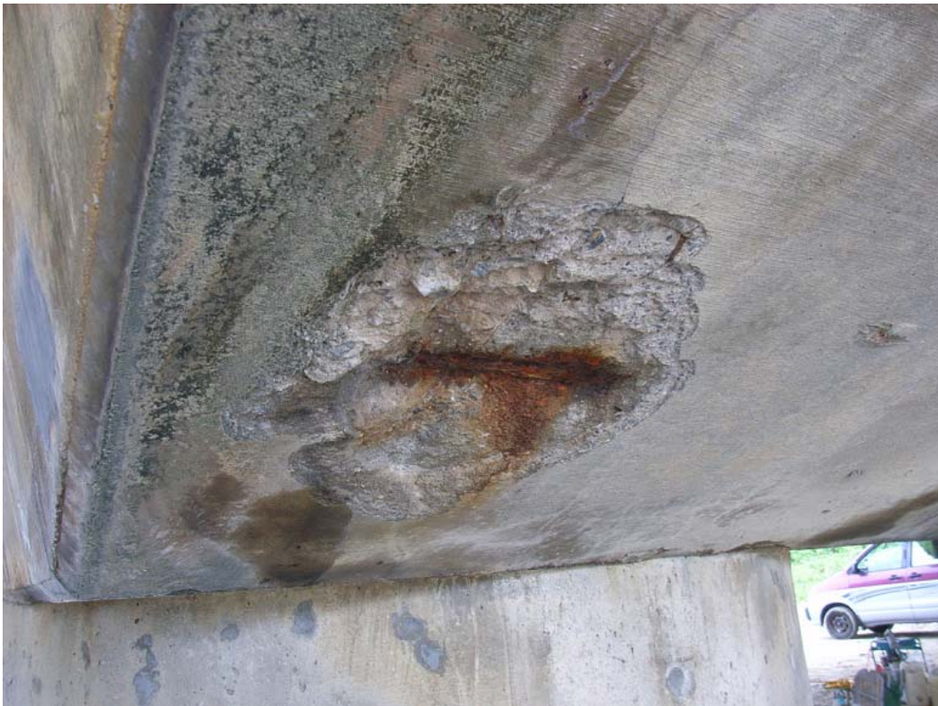
写真 6 : 鉄筋の腐食具合
